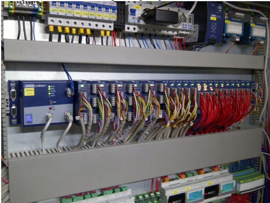
Das Mess-, Regel- und Automatisierungssystem Mtron T von Jumo steuert und regelt sämtliche Kühlprozesse. Bild: Jumo
