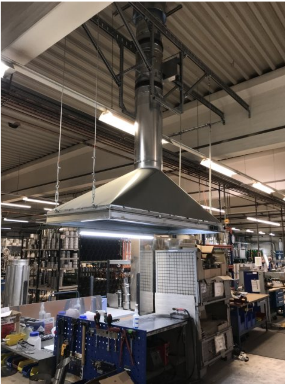
Absaugung eines Putzplatzes in der Edelstahlbearbeitung (Bild: Nestro).
