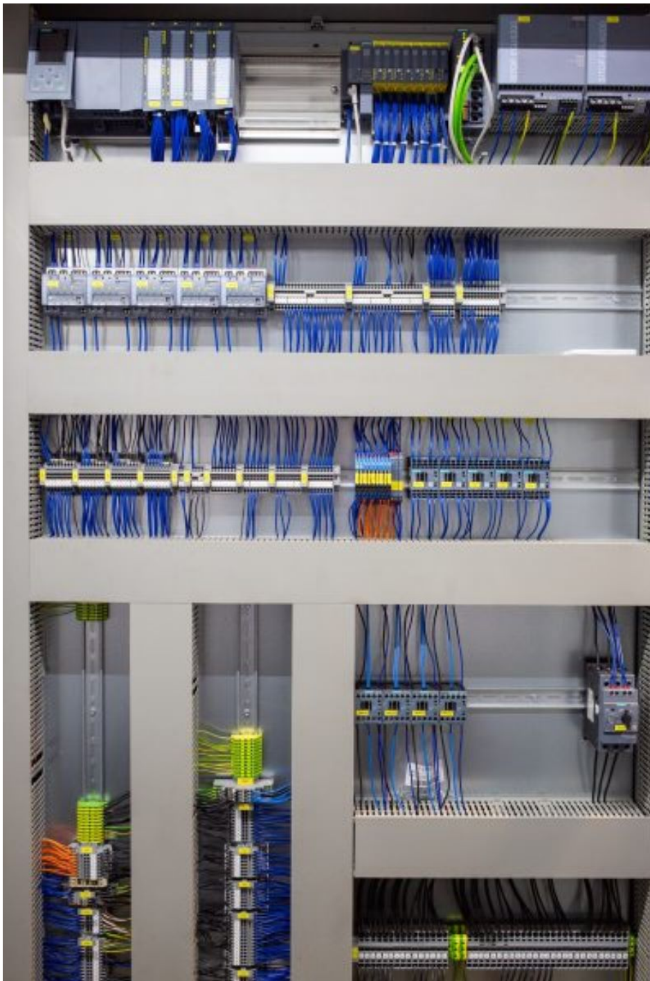
Schaltschrank vor und nach der technischen Überholung (Bild: Heitec).
